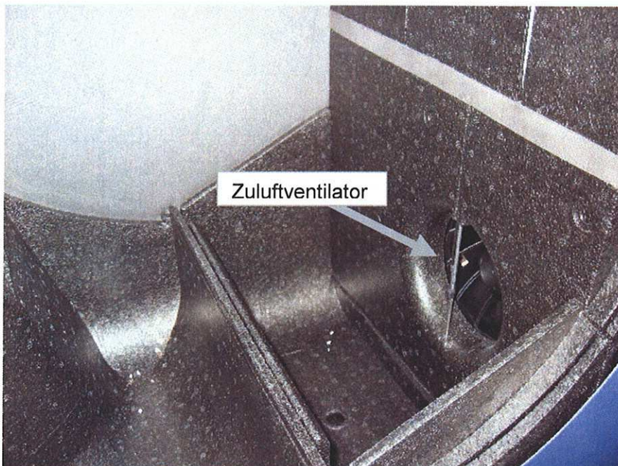
Bild 8: Blick auf den Zuluftventilator
